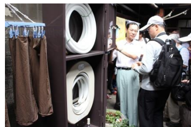
屋外易操作消火栓
