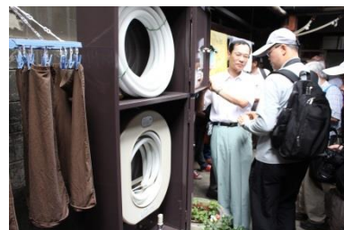
屋外易操作消火栓
