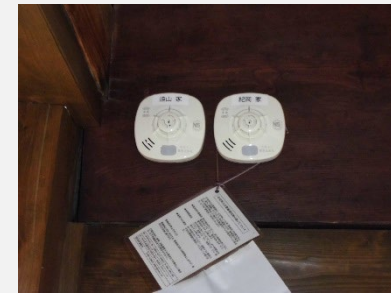
自動火災報知器
