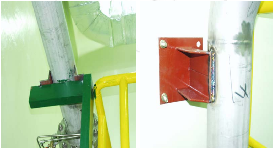
그림 1-7 6" 회수관 상류 중심 지지부 및 측면 지지부
