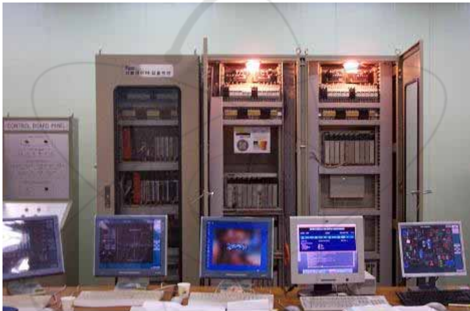
<그림 14> 제어봉구동장치 제어시스템의 성능검증장치
