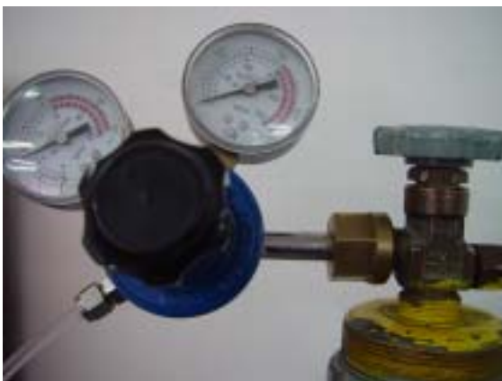
그림 4.4.3 Leak-Test Monitoring Gauge
