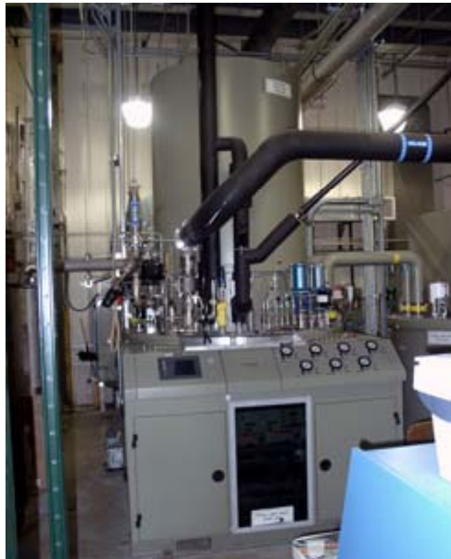
FIG. 15. Helium refrigerator cold box.
