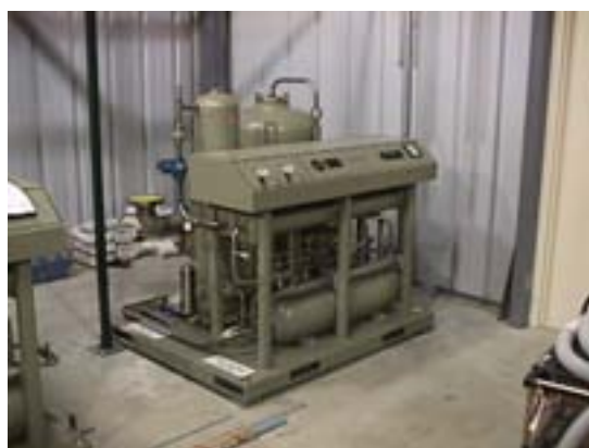
FIG. 13. Helium compressor skid.
