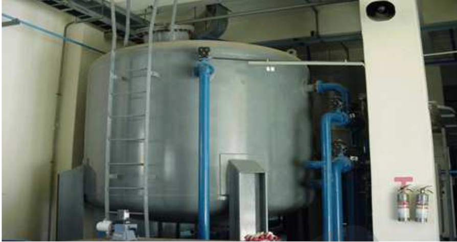
그림 5-3. 모래여과조, 활성탄여과조 및 이온교환수지여과조
