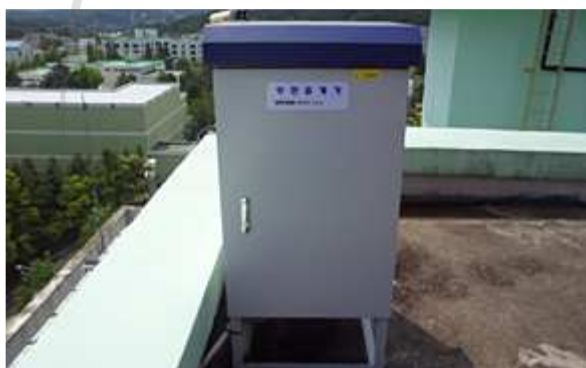
그림 4-13. 하나로동 옥상설치 무전기증계기
