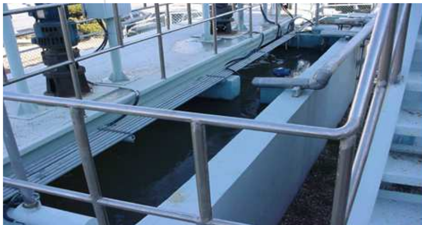
그림 5-1. 반응조, 급속응집조 및 완속반응조 전경
