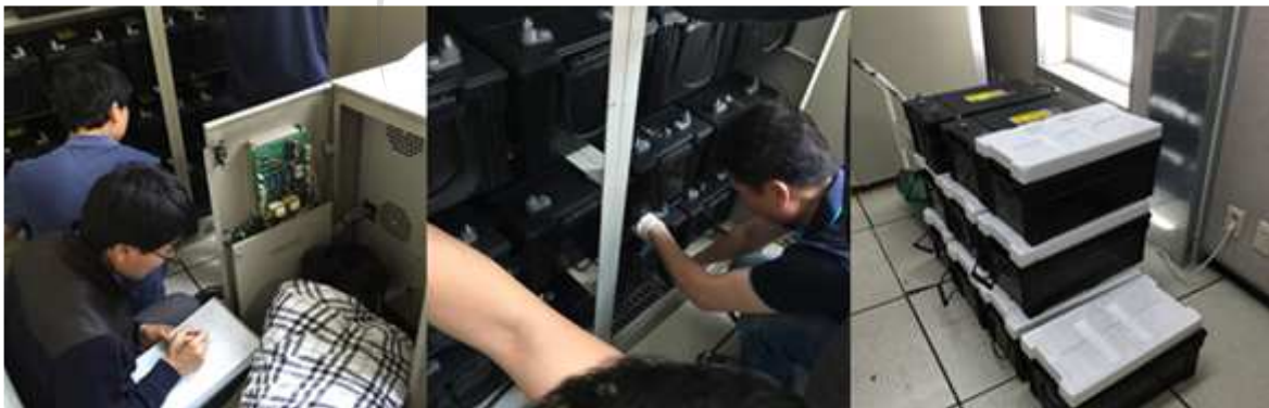
그림 4-11. 본부상황실 UPS/배터리 점검, 배터리 교체
