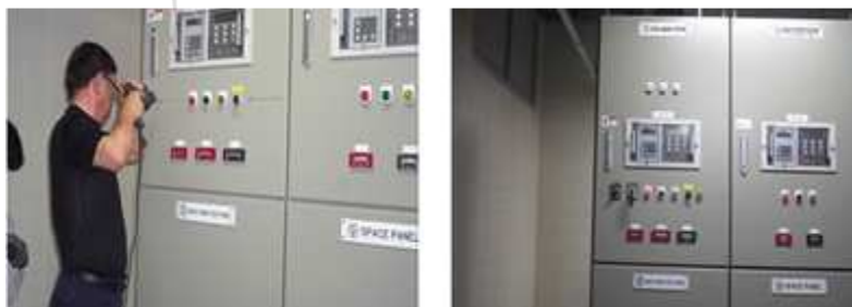
그림 4-16. 본부상황실 비상전원 자동정기변환 장치설치 전후
