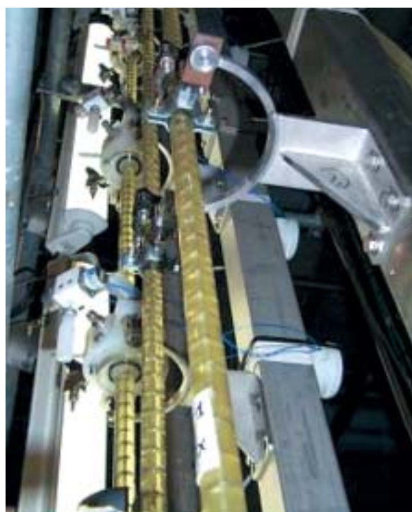
Fig. 132. Vue des colonnes pulsées, implantées dans la Chaîne Blindée Procédés de l'installation ATALANTE pour les essais de démonstration de la faisabilité technique de la séparation poussée réalisés en 2005.
