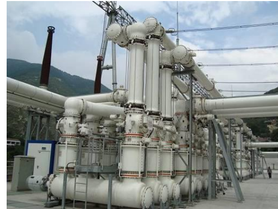
SE Maoxian después del terremoto
