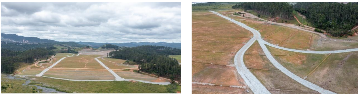
Figura 11. Implantação dos canais periféricos de drenagem, CP 01 e CP 02 - Dique 2, concluída em outubro de 2023. Fonte: Vale, 2024.
