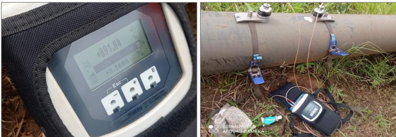
Figura 20. Registro da medição de vazão no sistema de bombeamento da barragem Xingu.
