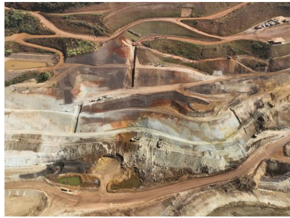
Foto 4. Vista da construção de canais de drenagem da ombreira direita. - Obras de execução do PRAD. (Fonte: Vale, 15 de julho de 2024).
