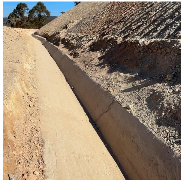
Foto 6. Execução de canaletas na ombreira direita - Obras de execução do PRAD (Fonte: Vale, julho de 2024).
