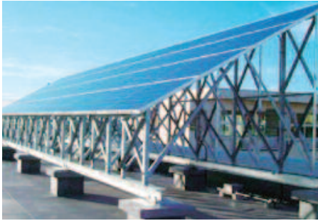
太陽光発電システム
