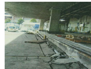
地震による施設被害
