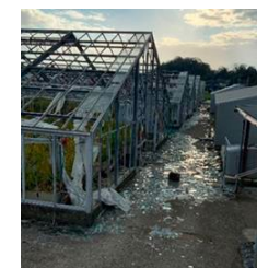
被災したガラスハウズ6 (令和元年房総半島台風)
