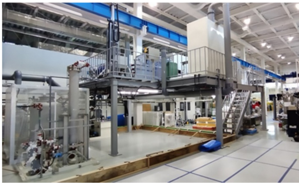
Figure 1: COI 棟内南西部の EP 設備エリア (~130 m 2 ).
